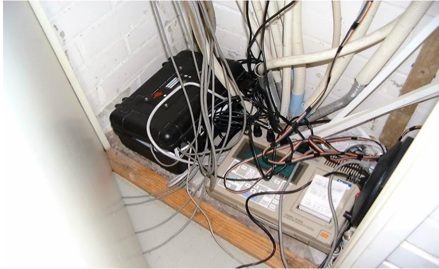
Kuva 9. Sähköteho mitattiin sähkökeskuksesta.
