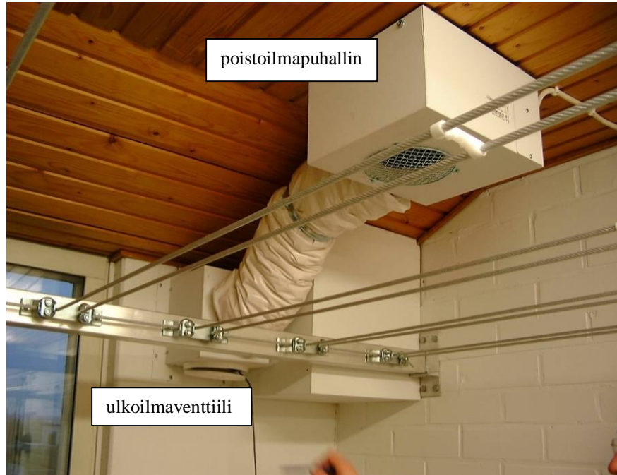
Kuva 5. Velco-poistoilmapuhallin ja ulkoilmaventtiili sekä pyykin kuivausrakot kaksoisnarutuksella.
